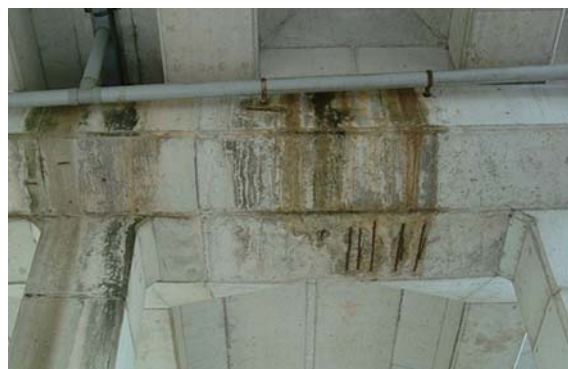
図2 かぶり不足による鉄筋露出
