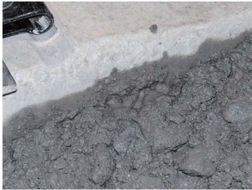
図8 劣化したバラストの例
