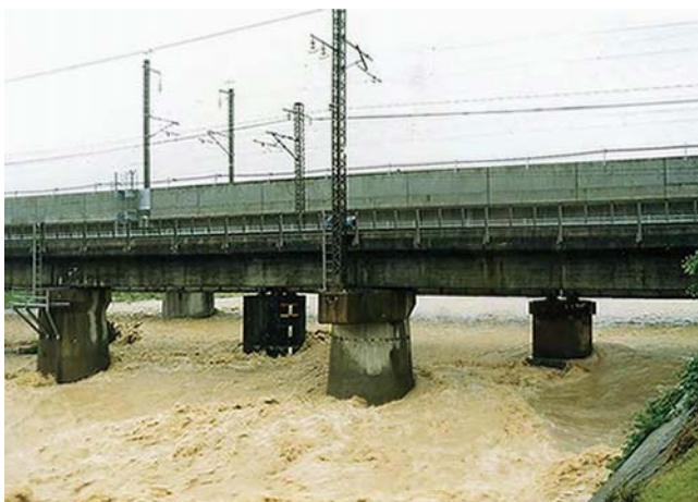
図3 橋梁付近の増水した河川の流れの様子
