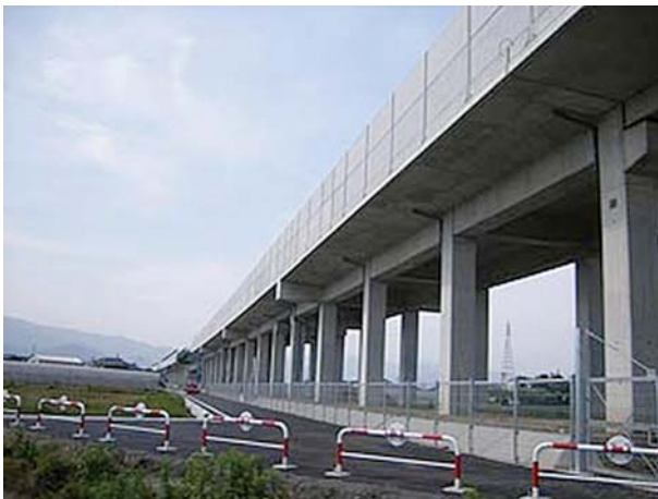
図8 回転杭を用いたRCラーメン高架橋 (九州新幹線博多・新八代間, 島田北BL)
