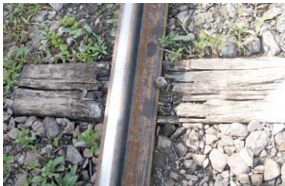
図1 締結部周辺が腐食したまくらぎ
