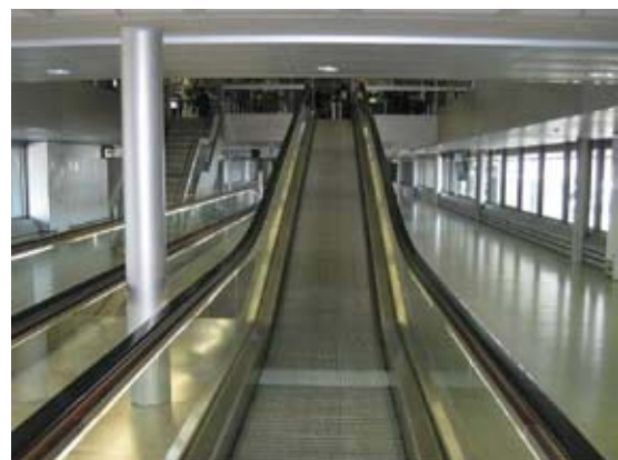
図7 オートスロープ(チューリッヒ空港)
