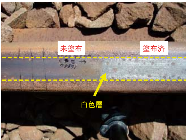
図1 レールに発生した白色層の外観
