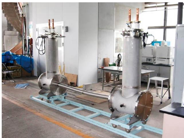
図1 直流き電用超電導ケーブル装置
