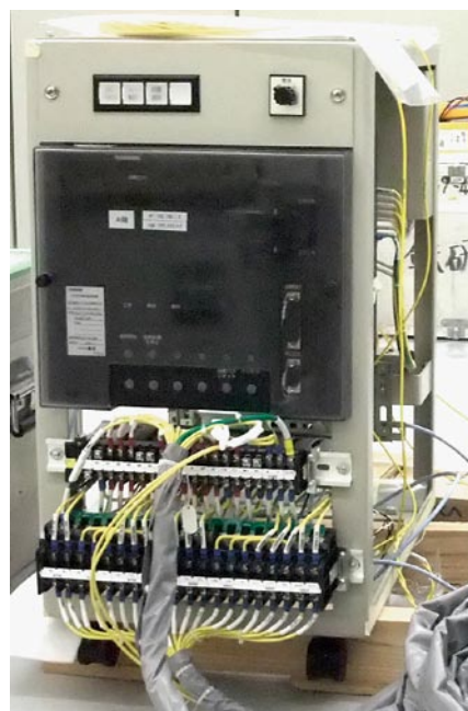
図 長距離き電用保護継電器の外観
