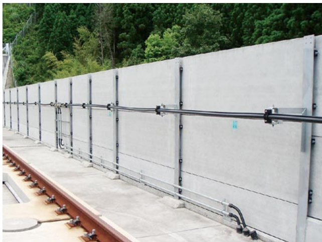
図4 新幹線に布設されたLCXケーブル
