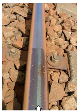
図3 レールに発生した白色層
