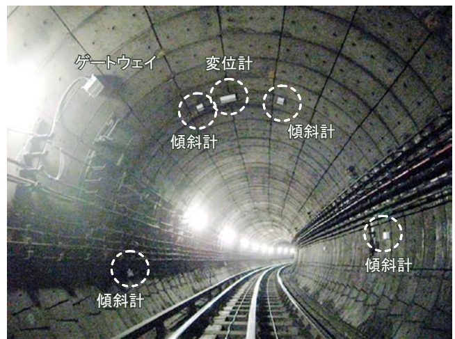
図4 センサの設置状況(トンネル内)
