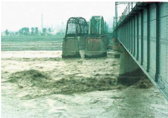
図1 橋脚が倒壊した災害の例
