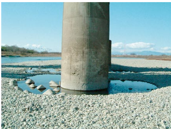
図2 橋脚周りで発生した洗掘の様子
