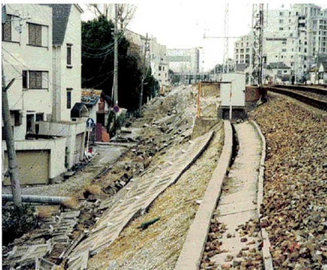
図3 兵庫県南部地震における鉄道盛土の被災
