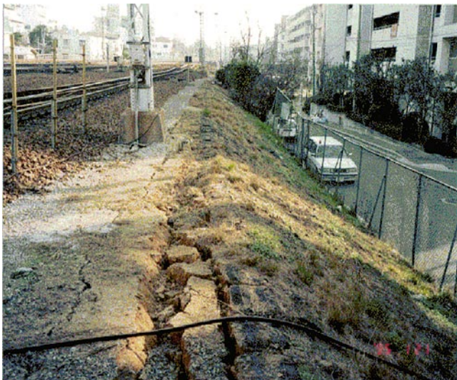
図2 兵庫県南部地震における鉄道盛土の被災
