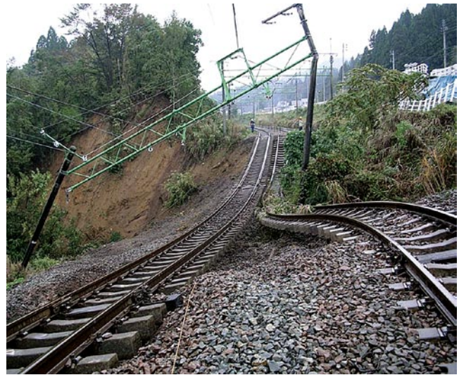
図4 新潟県中越地震における鉄道盛土の被災
