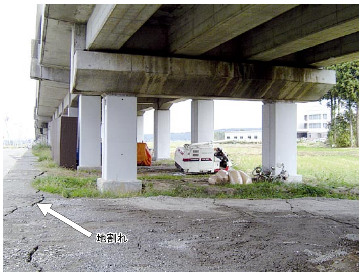
図1 柱が鋼板巻立て補強された高架橋の地震後の状況
