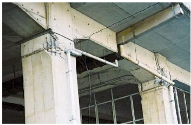
(a)コンクリートのはく落
