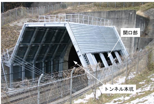
図3 新幹線に設置されているトンネル緩衝工
