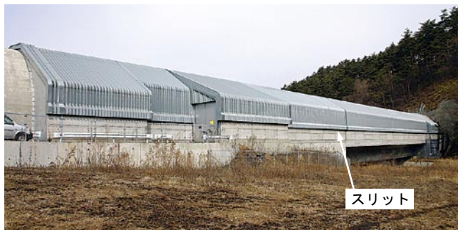
図9 新幹線に設置されているスリット付スノーシェルター
