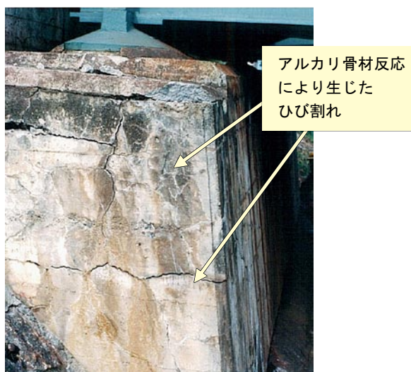
図3 アルカリ骨材反応が生じたコンクリート構造物
