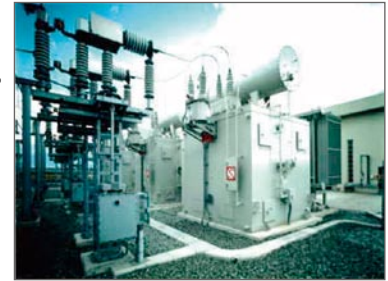
図5 長野車両基地変電所 SFC
