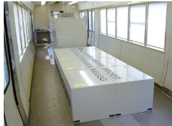
図3 リチウムイオンバッテリー(手前)とバッテリー充放電装置(奥)のクモヤR290形車両への搭載状況
