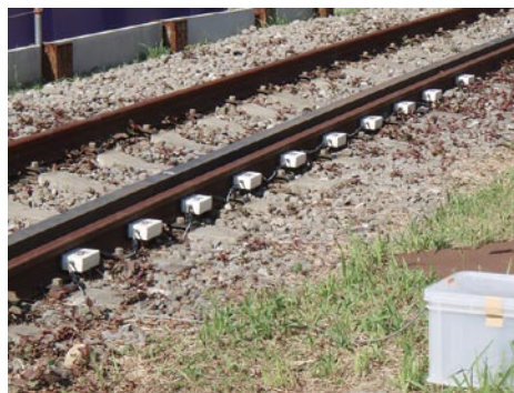
図7 無線センサネットワークを用いた軌道変位監視システム(試作機)
