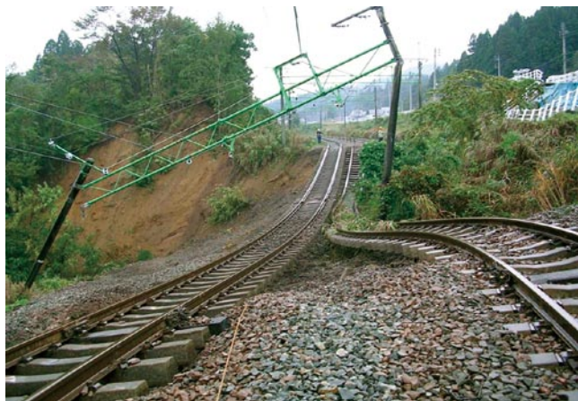
(b)被災した盛土の状況2
