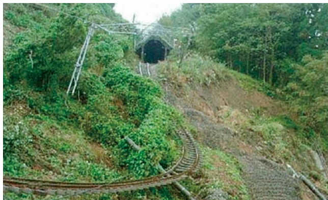
(a)被災した盛土の状況1
