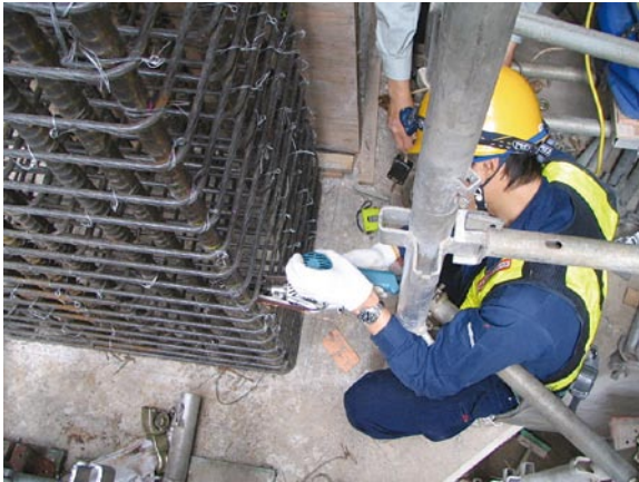
図13 検知センサ設置状況
