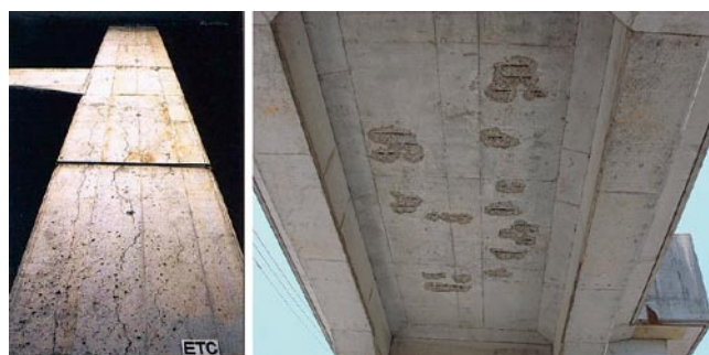
(a) ひび割れ
