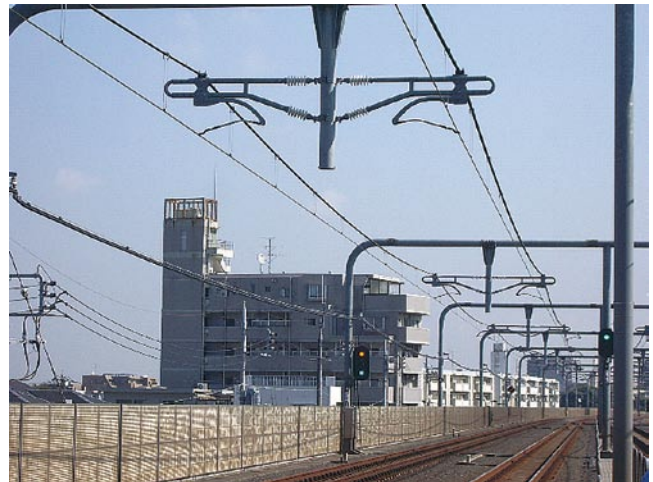
図11 新しいき電ちよう架式電車線
