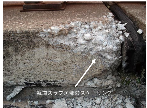
図8 軌道スラブの凍害による損傷状況
