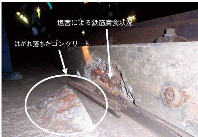
図7 軌道スラブの塩害による損傷状況
