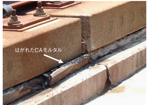
図5 凍害によるCAモルタルの損傷状況
