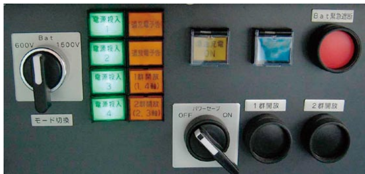
運転台スイッチパネル上にある複電圧架線ハイブリッド型走行の電源モード切替えスイッチ
