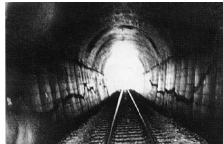
図4 側壁中央をトンネル軸に沿って走るクラック
