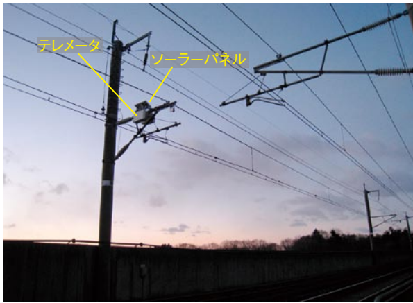
図3 架線の計測データを伝送するテレメータ
