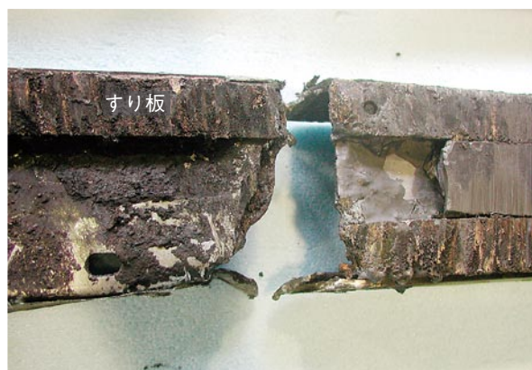
図2 離線アークにより溶断した舟体
