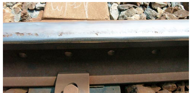
図7 曲線部外側レールに発生したき裂
