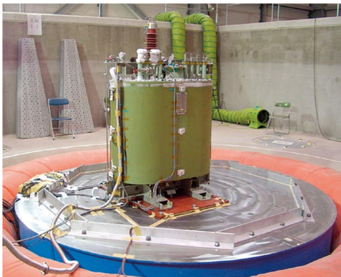
図 超電導主変圧器
