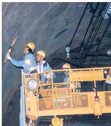
図1 打音調査状況の例
