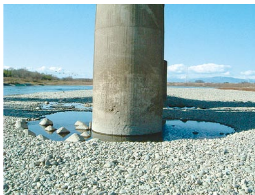
図1 橋脚周りで見られる洗掘の様子
