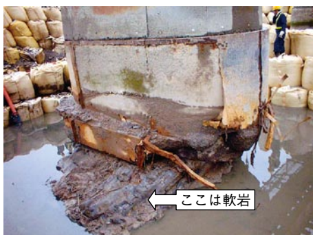
図1 直接基礎の洗掘被害状況
