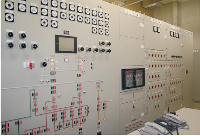
図5 芸大通変電所 制御監視盤
