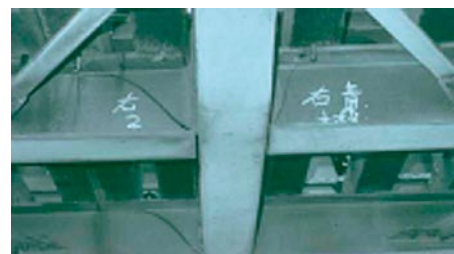
図3 疲労き裂が原因で部材が破断した例
