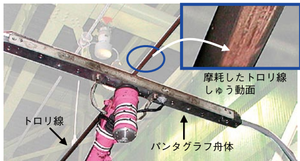
図1 トロリ線の摩耗状況
