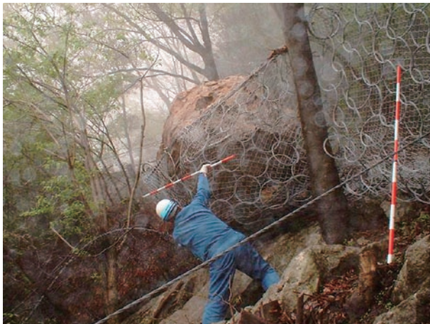
図1 リングネット落石防護柵と落石捕捉
