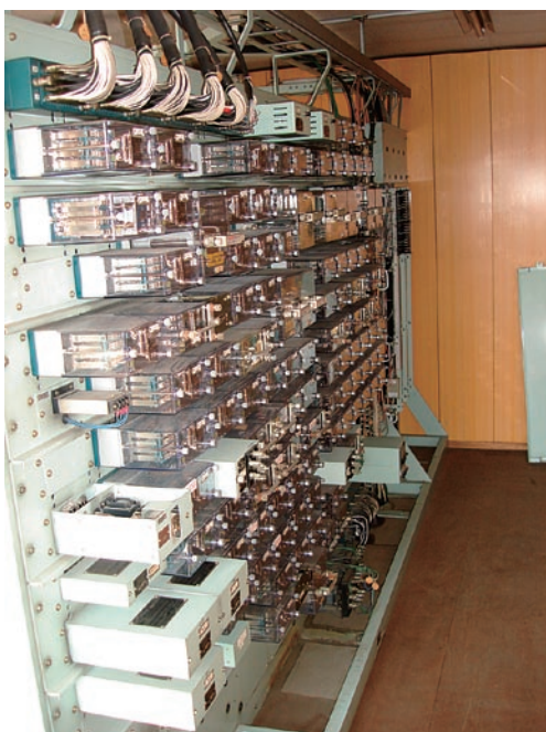
図2 特殊自動閉そく装置(リレー架)
