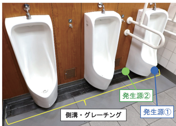
図 11 D 駅男子トイレ (発生源①②はともに側溝内)
