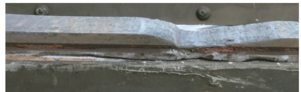
図2 すり板局部摩耗の例
