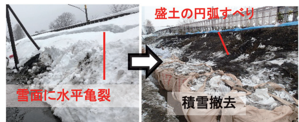
図1 積雪斜面（盛土）における崩壊事例 1)
