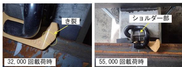
(a) き裂の発生初期 (b) インシュレーターの喪失直前
