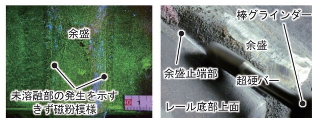
図1 余盛止端部の未溶融部 図2 余盛止端部の研削処理
