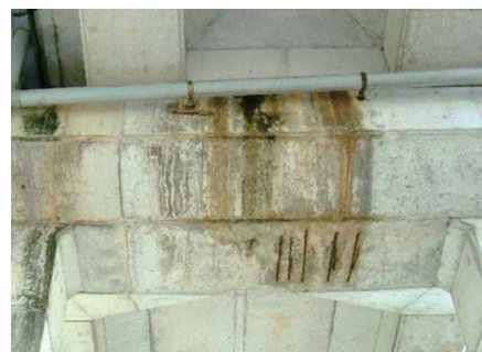
図2 水掛かりとコンクリートの剥落状況 3)
