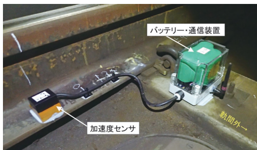
図5 センサユニットの設置状況
