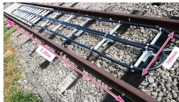
図 7 高圧リッツ線ケーブルによる地上コイル
