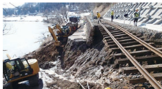
写真2 融雪災害発生後の崩壊面
