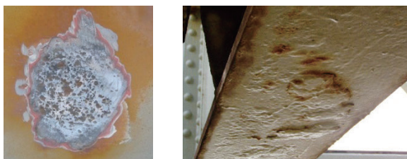
図1 素地調整後のさびの残留 1) 図2 塗膜下の腐食進行例 1)
