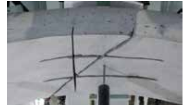
図8 天端初期ひび割れ (ケース6) 4)
