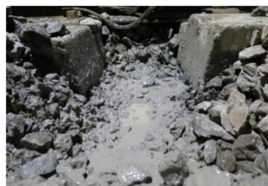
図2 保守頻度が多い地点のバラストの状態(地点6) 5)
